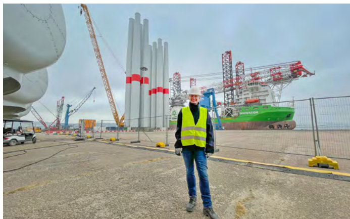
Eva Winkelmann in Cherbourg, wo die Vormontage stattfindet. Hier werden die verschiedenen Komponenten (Turm, Blätter und Gondel) auf ein Errichterschiff geladen, das die Installation auf See vornimmt. Das Errichterschiff oder auch Installationsschiff ist im Hintergrund zu sehen und heißt „Sea Innovation“. Fotos: Siemens Gamesa
