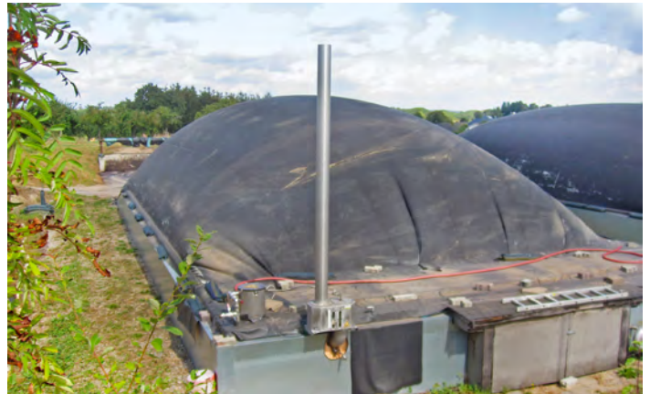
Fahrsilo-Biogasanlage der Bioenergie Herforst in der Eifel
