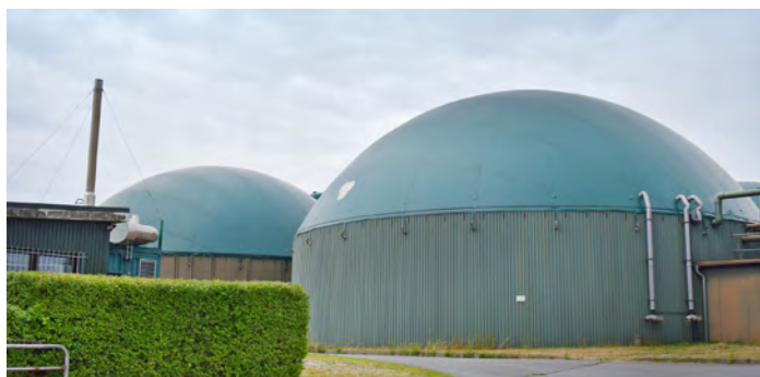
Wie in Brügge produziert die große Mehrzahl der Biogasanlagen Strom und Wärme aus nachwachsenden Rohstoffen.
