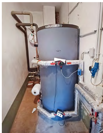
Pufferspeicher im ehemaligen Heizraum eines Nebengebäudes
