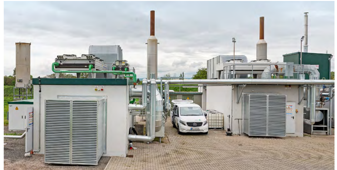
Ein Teil des Rohbiogases dient als Treibstoff für zwei Jenbacher-BHKW mit einer elektrischen Leistung von 1.200 beziehungsweise 1.500 kW. Fotos: Carmen Rudolph
