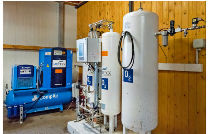
Die Entschwefelung des Rohbiogases erfolgt durch die Zugabe von selbst erzeugtem reinen Sauerstoff.
