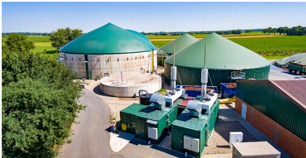
Ab Dezember 2026 ist für Gülle- und Gärrestlager bestehender Biogasanlagen eine Minderung für Ammoniak- und Geruchsemissionen um 85 % gegenüber einer Lagerung in offenen Behältern vorgeschrieben. Foto:Imago
