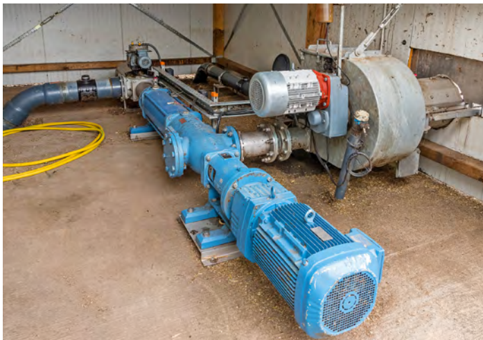
Eine Exzenterschneckenpumpe drückt die in der Mixbox mit Rezirkulat angemischten Feststoffe in den Fermenter.
